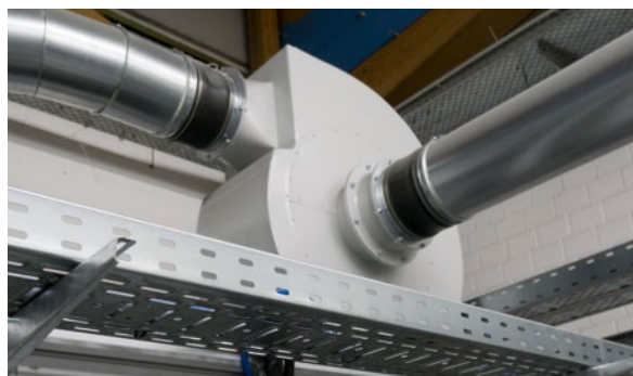
Transportventilator im Einsatz
